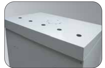
Dachansicht mit vorbereiteten Rohrdurchführungen und Abluftanschluss
