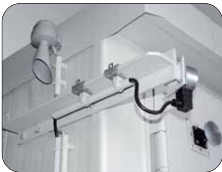
- Ex-geschützte Abluftüberwachung mit Signalhupe - Türhalteanlage
