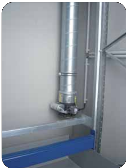
Ex-Abluftanlage inkl. brandgeschützter Lüftungselemente
