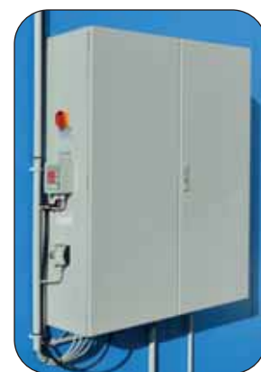
Schaltschrank mit zentraler Steuerung und Bedienelementen
