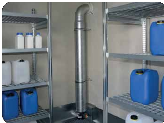
Ex-Abblaufanlage inkl. Abluftkanal bis Auffangwanne
