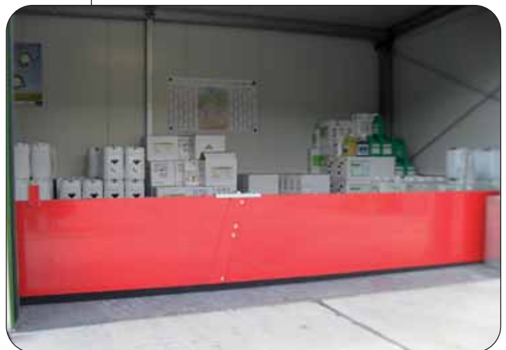
Löschwasserrückhaltung mit dreh-klappbarer Barriere
