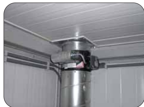
Abluftkanal mit K-90 Absperrvorrichtung
